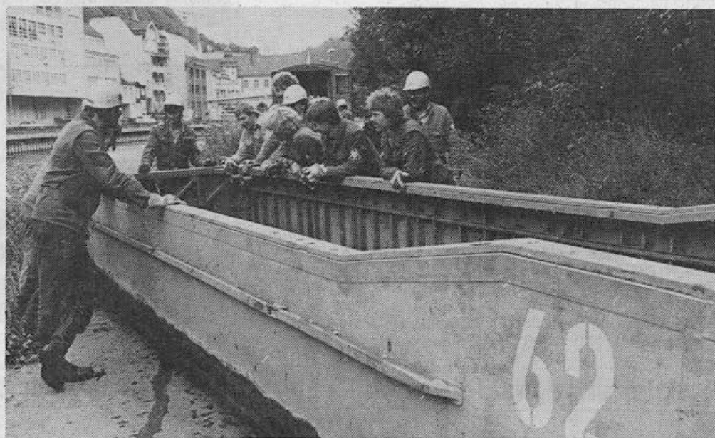
Am Nachmittag wurden die Pontons aus dem Wasser gezogen und auf Lkw verladen. Steine und Unrat in den Aluminiumbooten spritzten die THW-Männer mit Lennewasser aus. Die Brücke wurde ins THW-Lager nach Lüdenscheid gebracht.
